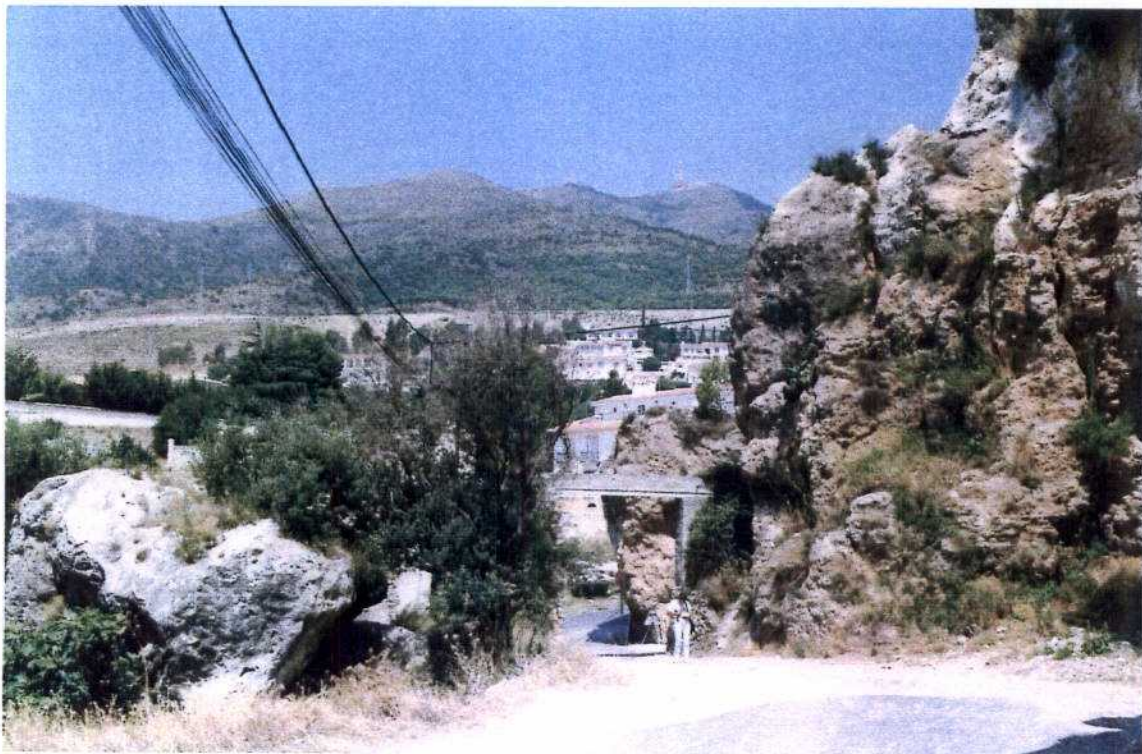
Fotografía 4.4. Vista del lado SE de la Zona 4, con las grietas verticales que independizan el bloque inestable. A la izquierda, uno de los bloques rocosos desprendido del macizo.
