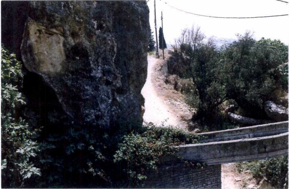
Fotografía 4.3. Base del bloque inestable de la Zona 4, sobre la que apoya un pequeño canal que aparece fracturado. Vista del lado W.
